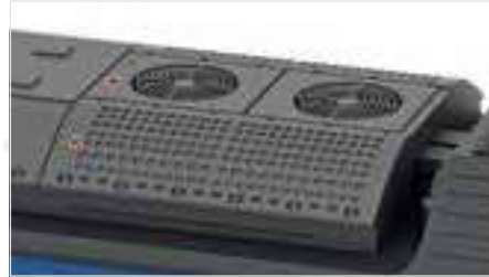
Korrekte Umsetzung der Klimaaggregate auf dem Dach
